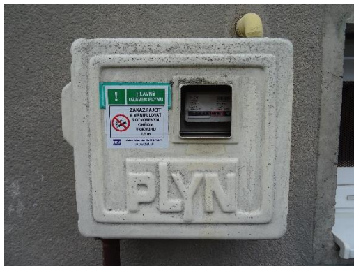
Obr. 5: Meranie spotreby zemného plynu pre celý objekt
